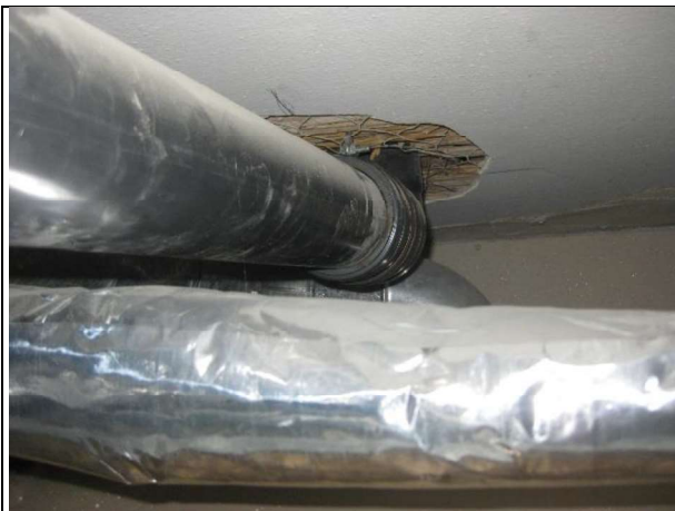
Gennemføringer i lejl. nr. 6.0.8 til overliggende baderum er ikke tætnet, samt skade på dæk
