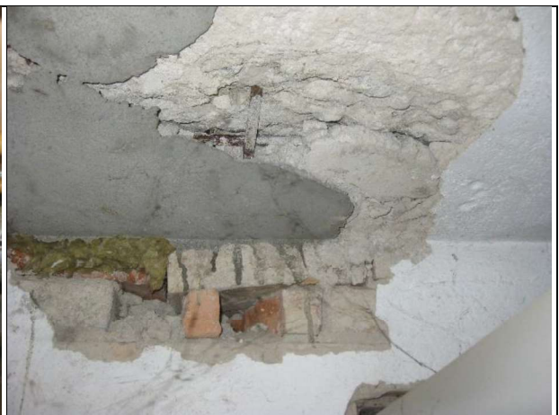
Skade på underside dæk i kælder ved vestfacade mellem modul 5 og 6.
