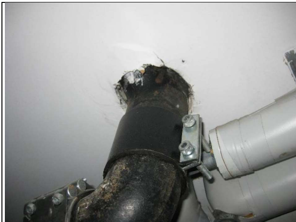
Manglende tætning i nyt etagedæk med trapezplade/gipsplader.
