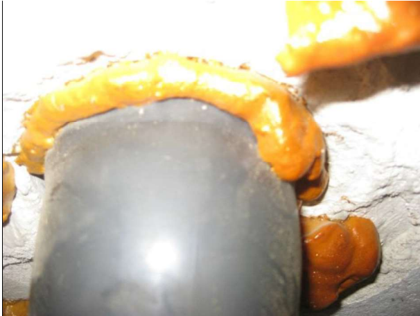
Tætning med montageskum omkring afløbsinstallation i kælder
