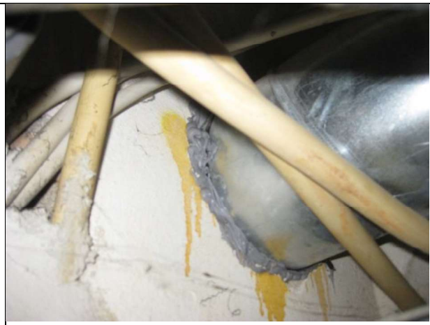
Ventilation ført ind i oprindelig skorsten er tætnet med fugemasse – 1. sal i administration. Væggen er sandsynligvis brandsektionsvæg
