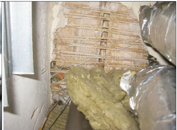
Skade på puds/etagedæk i lejl. nr. 6.2.1 (gennemføring ikke tætnet)
