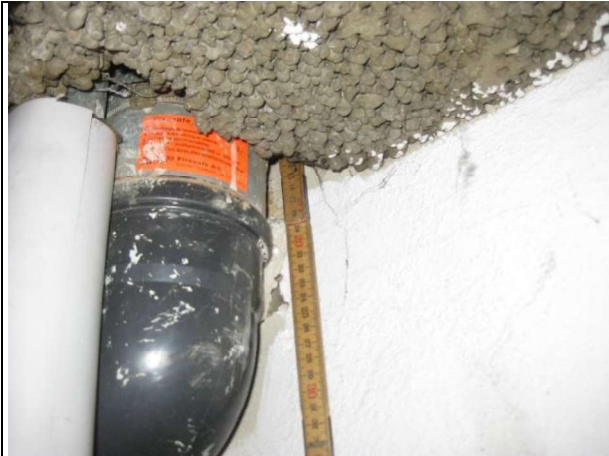
Tvivlsom udstøbning, med hul bag afløbsrør i kælder, manchete fastholdt til plastrør.
